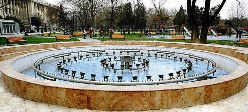
Vista Fontana Completa. Impianto con Pigna centrale, Anello Circolare e Fari Subacquei.
